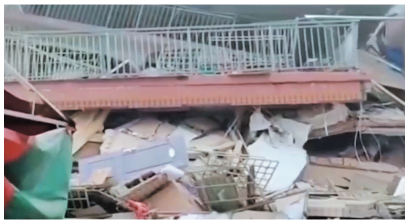
湖南省长沙市望城区金山桥街道的一栋居民自建房忽然下坐式垮塌。(视频截图)
