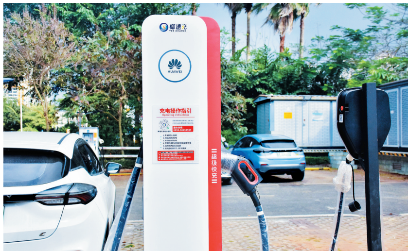
超充站里的充电桩。(省电供图)
