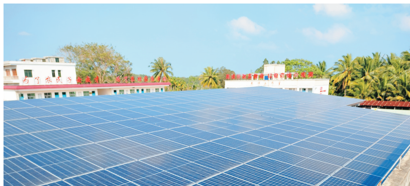
周家庄光伏电站的光伏板。
