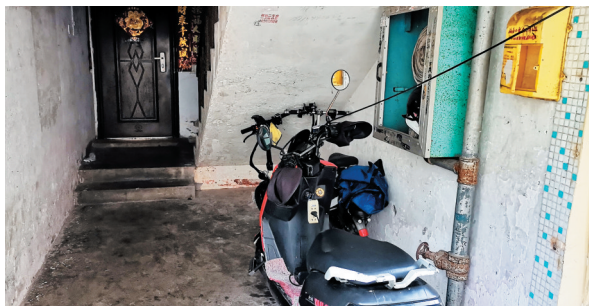
金山小区16栋楼梯口有业主私拉电线充电
