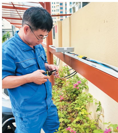
小区物业人员在检查线路。
