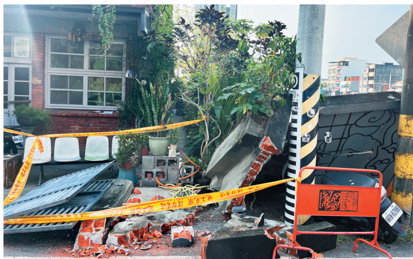
这是4月4日在花莲县花莲市区福建街拍摄的一处房屋，其墙体在前一天的强震中坍塌。 新华社记者 赵博 摄
