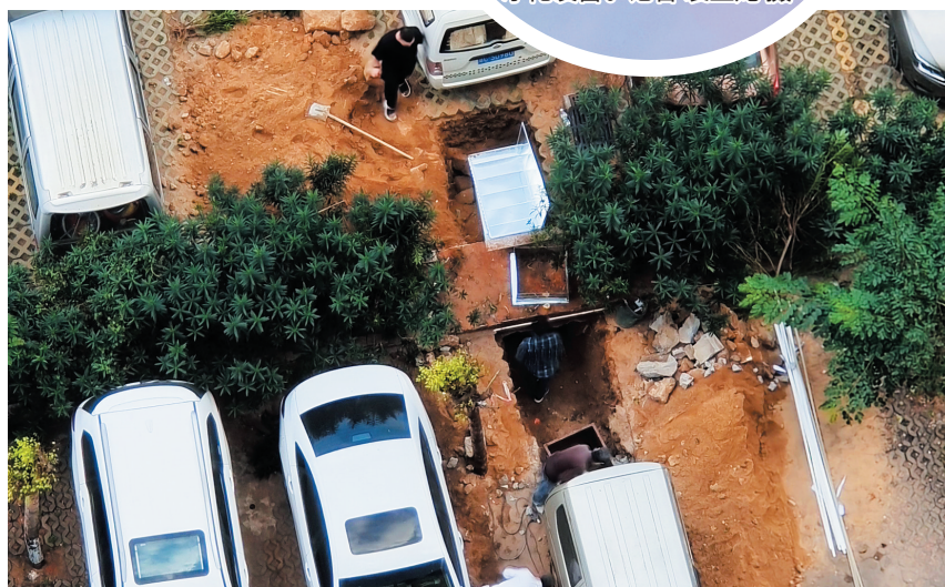
2022年1月16日,状元阁开挖地下油烟排放管道资料图。(受访者供图)
