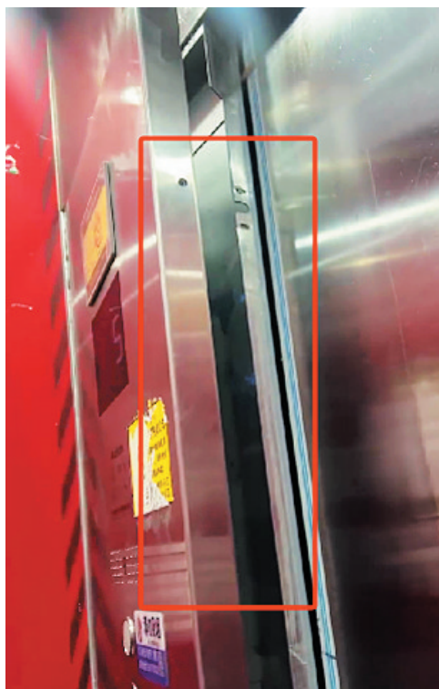
电梯间设备开裂。(业主供图)
