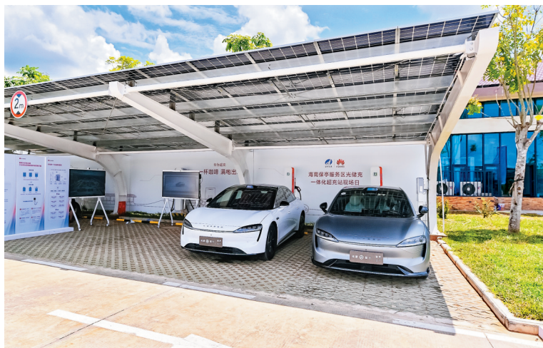
海南交投&华为保亭服务区“光储充”一体化样板点。海南交投&华为保亭服务区“光储充”一体化样板点。
