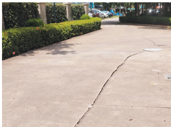
郁金香花园小区地面裂缝明显。
