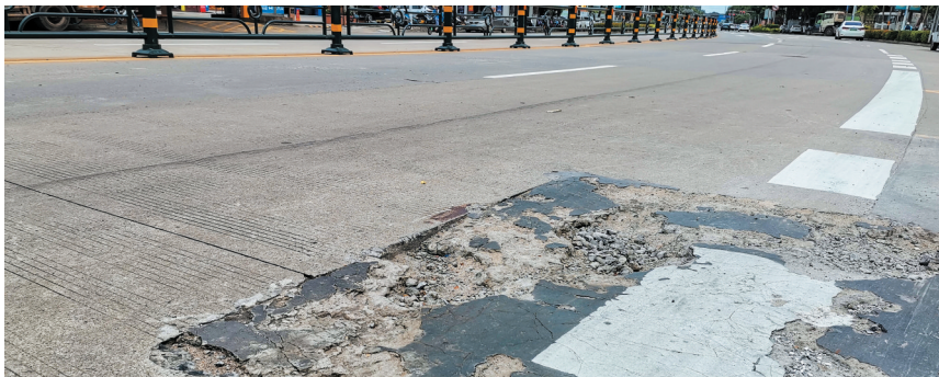
破损成坑的道路。
