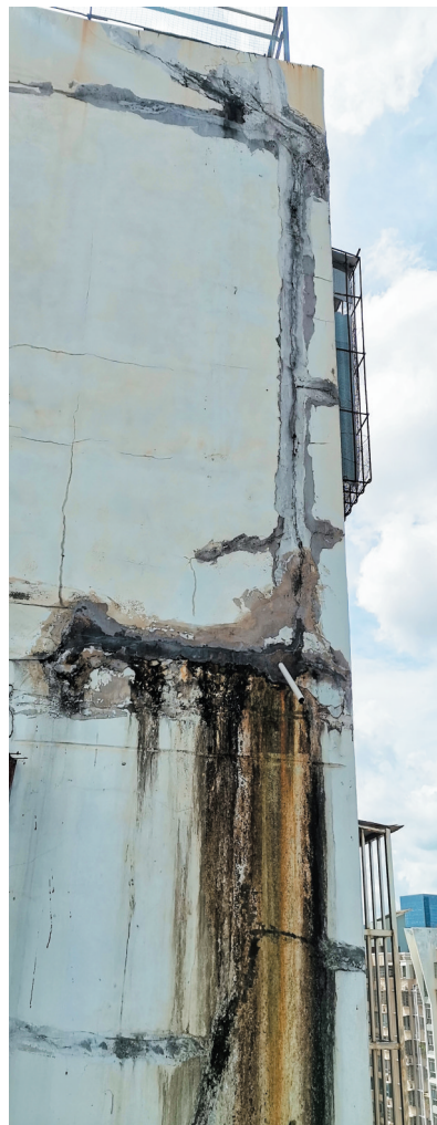
墙体长期渗漏水。
