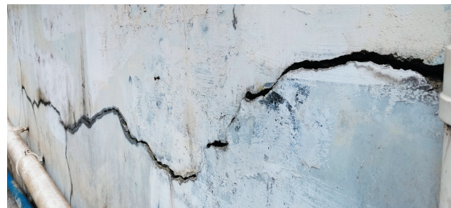
一楼墙体开裂较严重。
