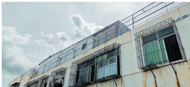
富骅大厦顶楼违规加建的房屋。
