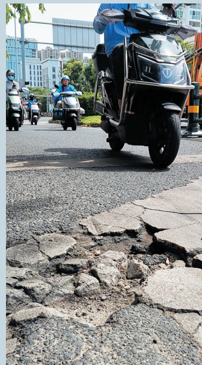
金车路一处非机动车道上坑槽给过往电动车出行带来隐患。
