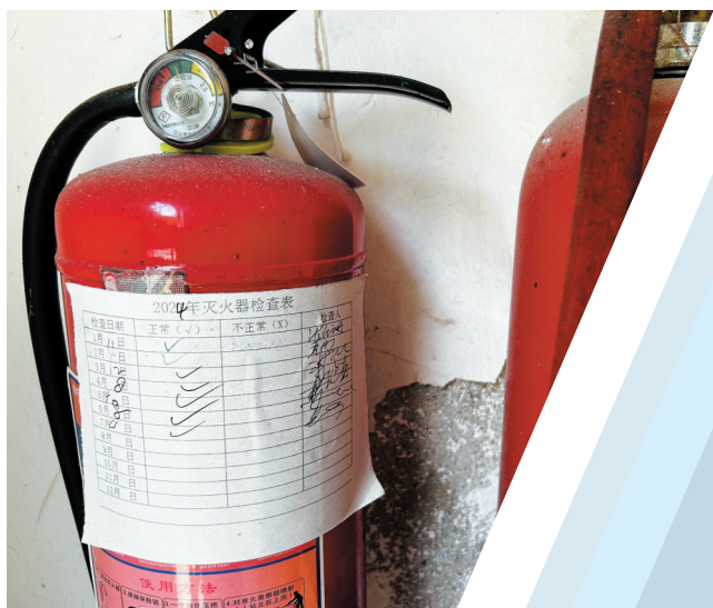
灭火器检查表上有人为涂改的痕迹。
