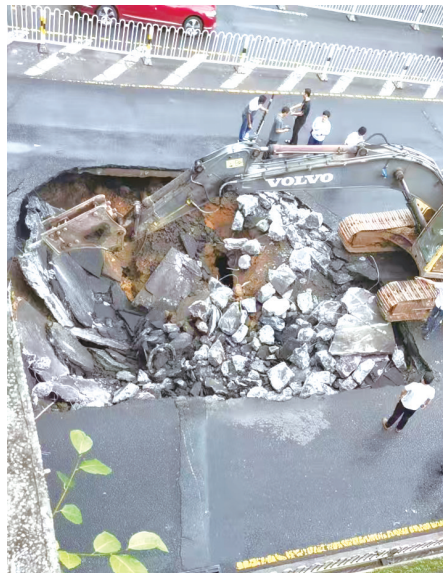
丘海大道海秀桥底下塌陷的路面。(市民供图)
