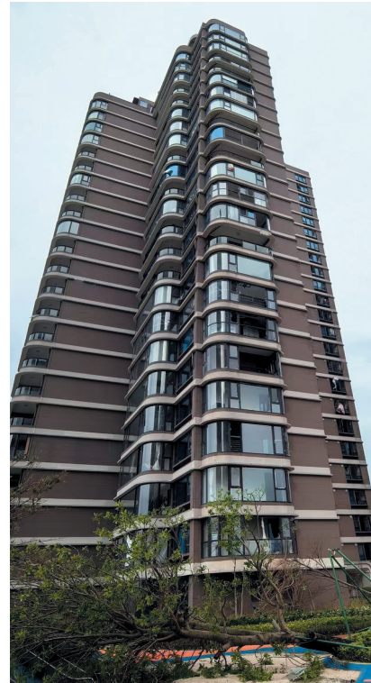
海口一小区部分房屋玻璃门窗受损严重。记者姜飞摄
