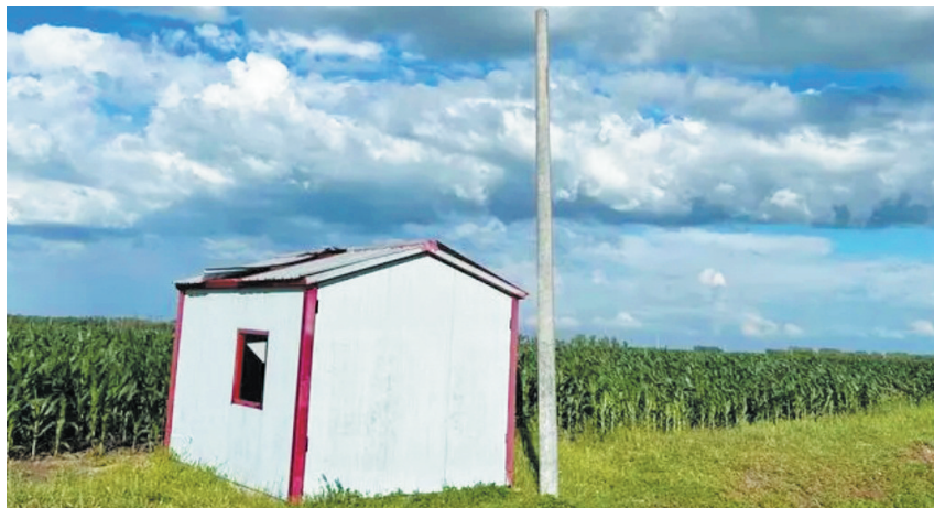
林甸县一处保护水源井的铁皮房出现破损，未见配套设施
