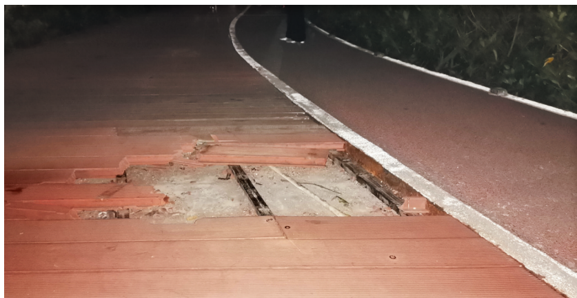
红城湖公园内亲水漫步道上部分受损路面已经形成坑槽。
