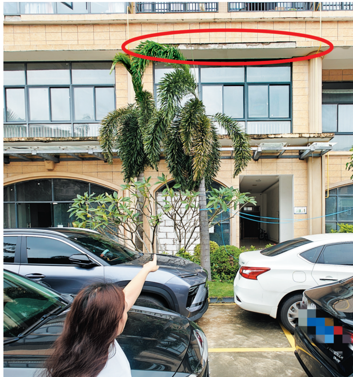
外墙瓷砖时有脱落,存在安全隐患。
