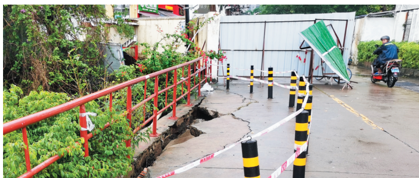
福安小桥南侧开裂较大的地方用新建的栏杆围起并拉起了警戒线。
