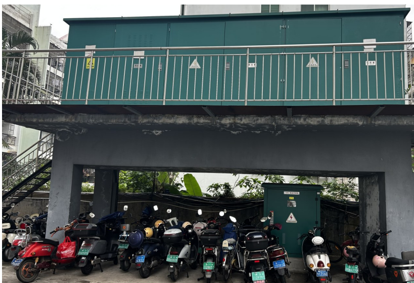
小区“1300KVA”公变架空层停满电动车，存安全隐患。
