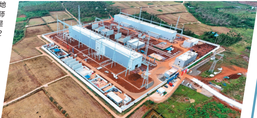
海南500千伏主网架工程施工现场。(省自然资源和规划厅供图)
