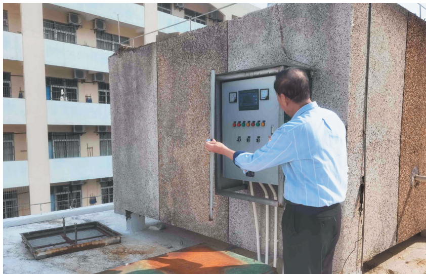
业主查看楼顶上的水泵开关。
