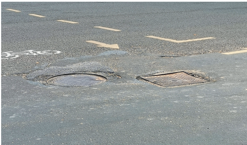
金牛路右拐进入南海大道交会口的路面上2个井盖及周边路面下沉凹陷。
