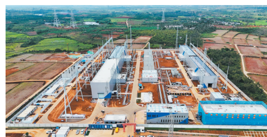
500千伏椰城变电站。通讯员 宋印官 摄
