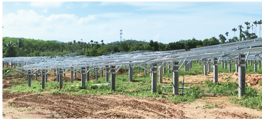
农光互补光伏发电项目设施。
