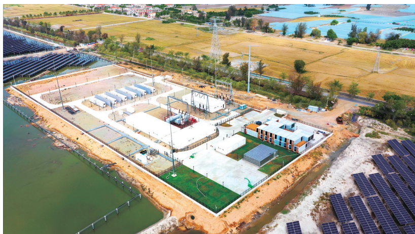
乐东莺歌海100MW光伏发电项目(二期)升压站航拍图。(通讯员供图)
