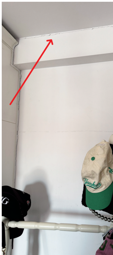
家中墙体开裂。
