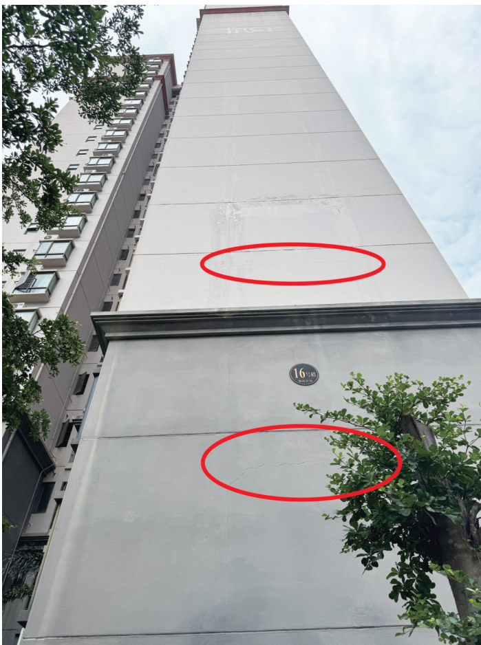
16号楼外墙出现细微裂痕。
