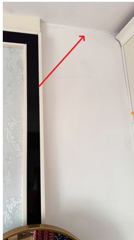
业主家中墙体出现裂痕。
