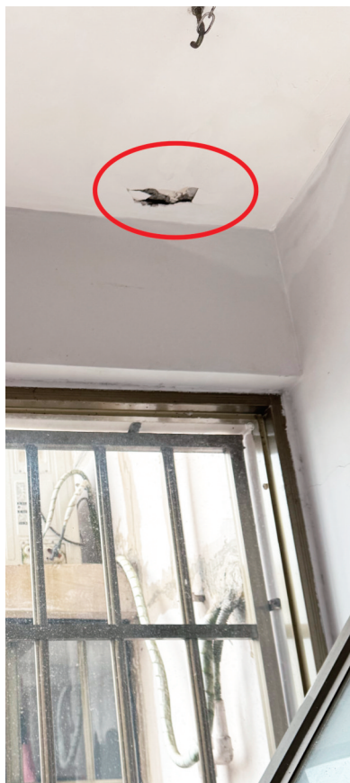
一业主家阳台顶部混凝土块脱落。
