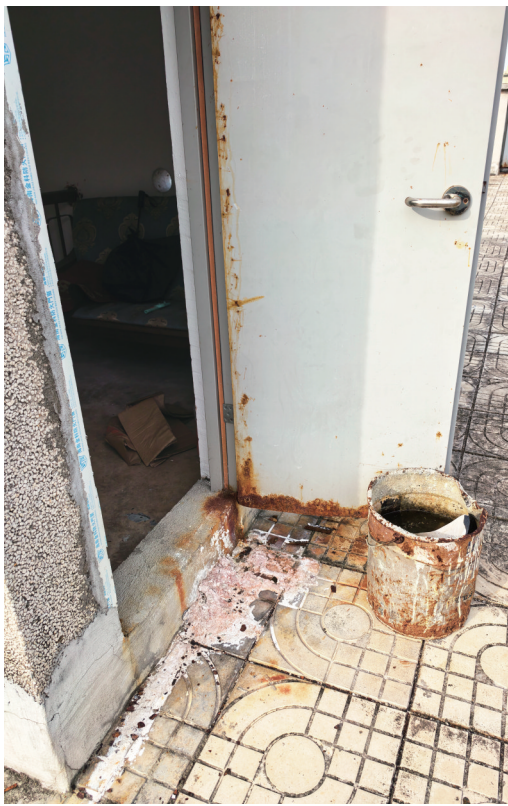
楼顶防火门生锈,防火材料掉落。(记者 李文韬摄)
