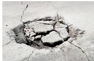
带有钢筋的路坑存安全隐患。 (市政维修单位供图)
