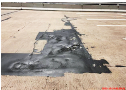
南大立交桥局部破损。(海口市路桥建设投资有限公司提供)
