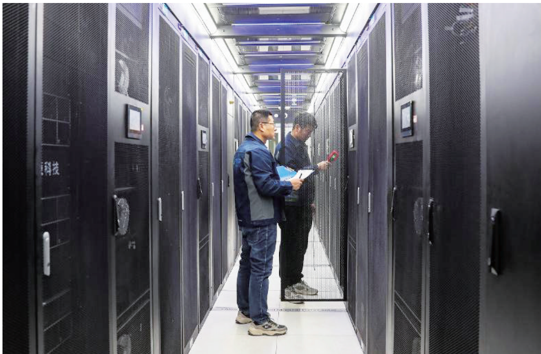
工作人员在中国移动(甘肃·庆阳)数据中心机房内巡检。新华社记者 郎兵兵 摄
