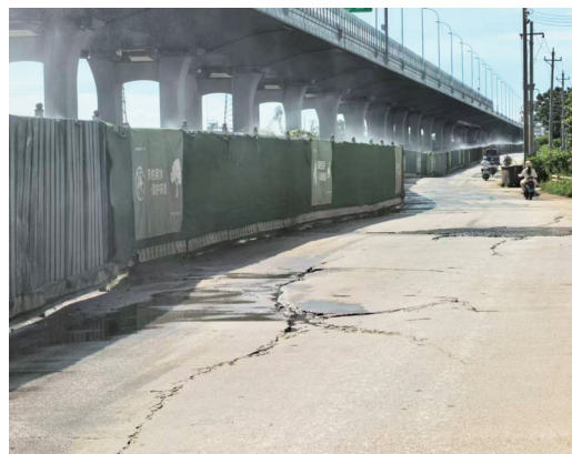
道路存在多处损坏。
