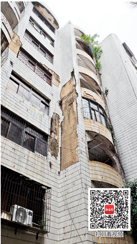
位于金花村的省一轻宿舍楼外墙体老化脱落严重。
