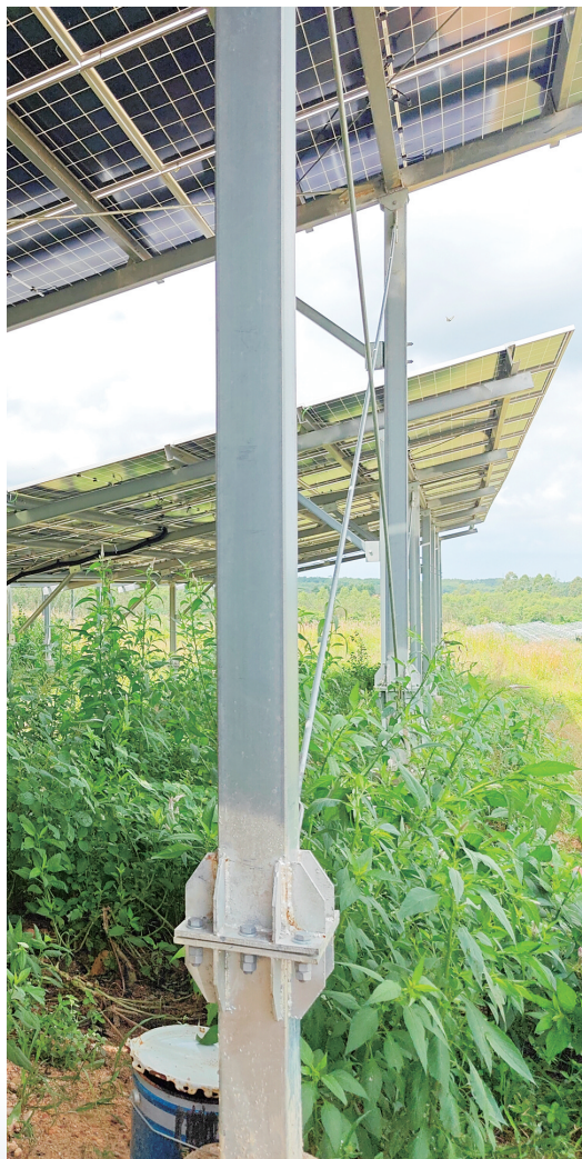
光伏板下杂草丛生。
