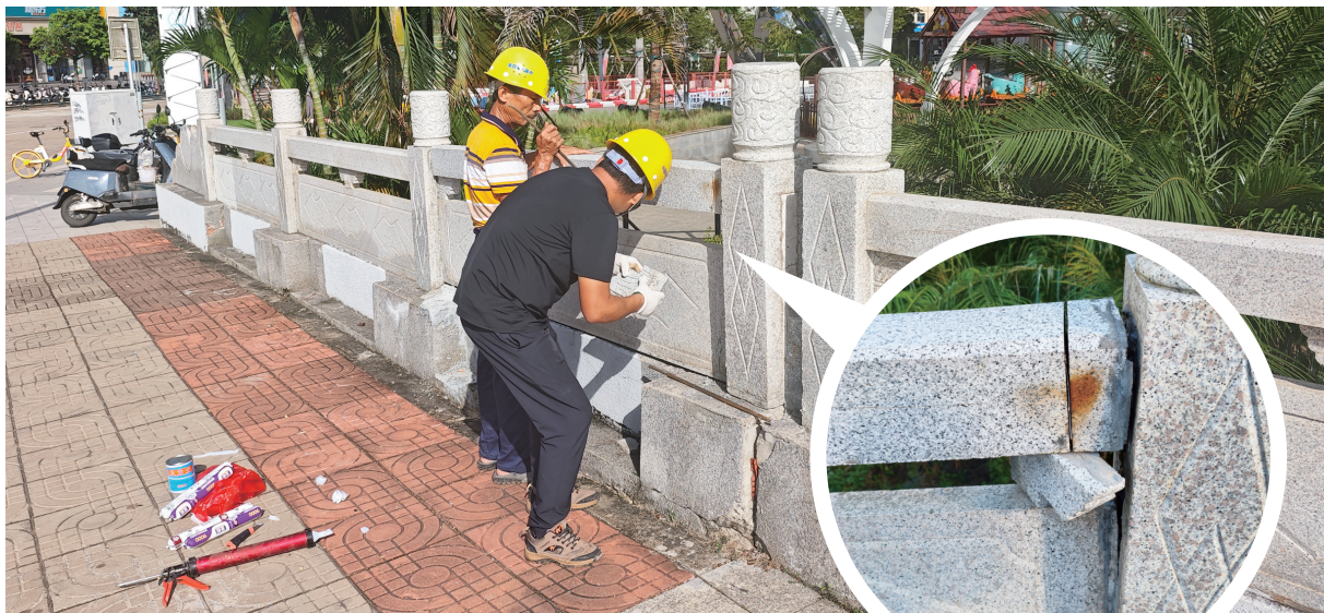
▲工人正在对桥梁栏杆进行维修。 ▶桥梁栏杆有较大缝隙。
