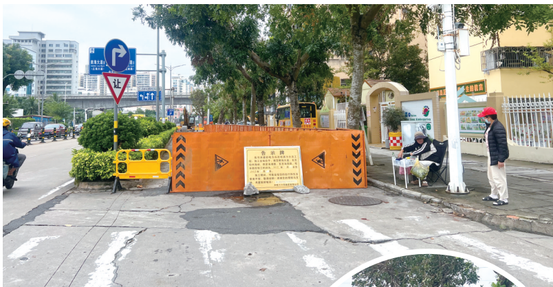
施工现场未预留电动车通道。
