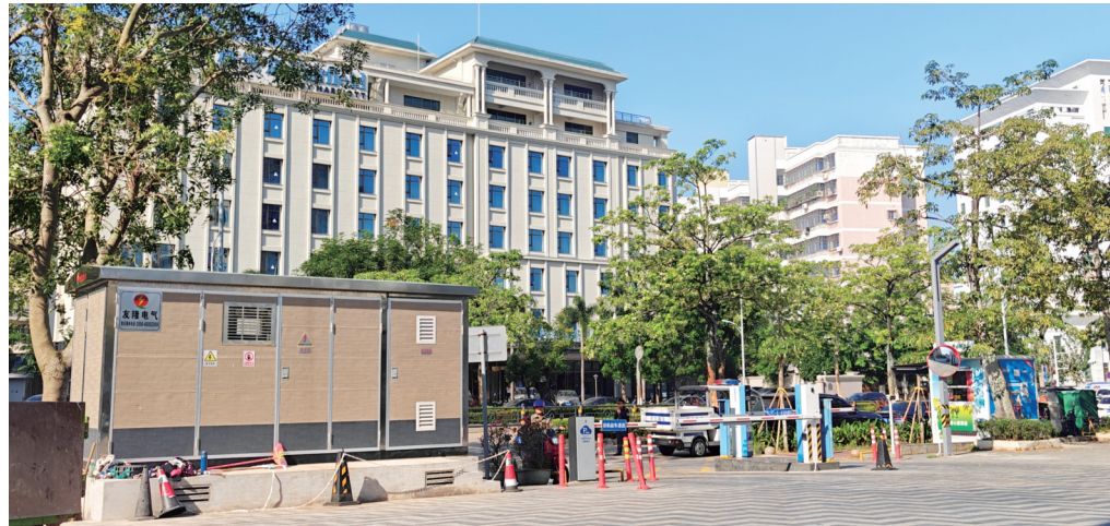
小区门口安装的变电器室。记者 姜飞 摄
