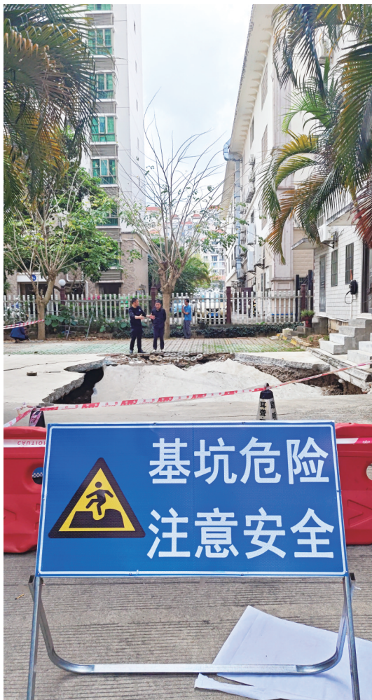
塌陷路面已放置防护栏。
