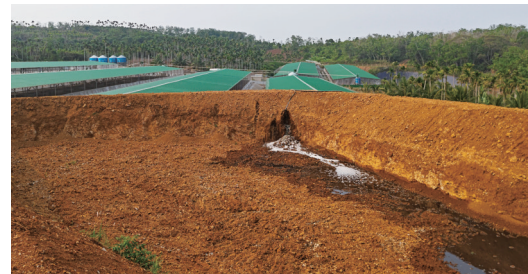
养猪场的蓄污池未建防渗漏措施。记者 苏桂除 摄
