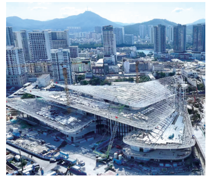
海南国际文化交流中心项目屋盖主体结构完工。(三亚中央商务区管理局供图)
