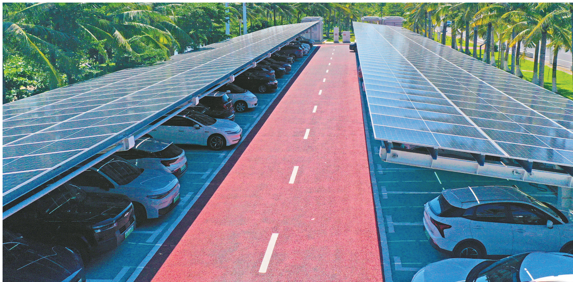
车棚上光伏发电,车棚下停满充电的车辆。
