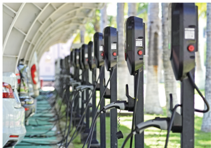
光伏车棚配备快慢充设备。
